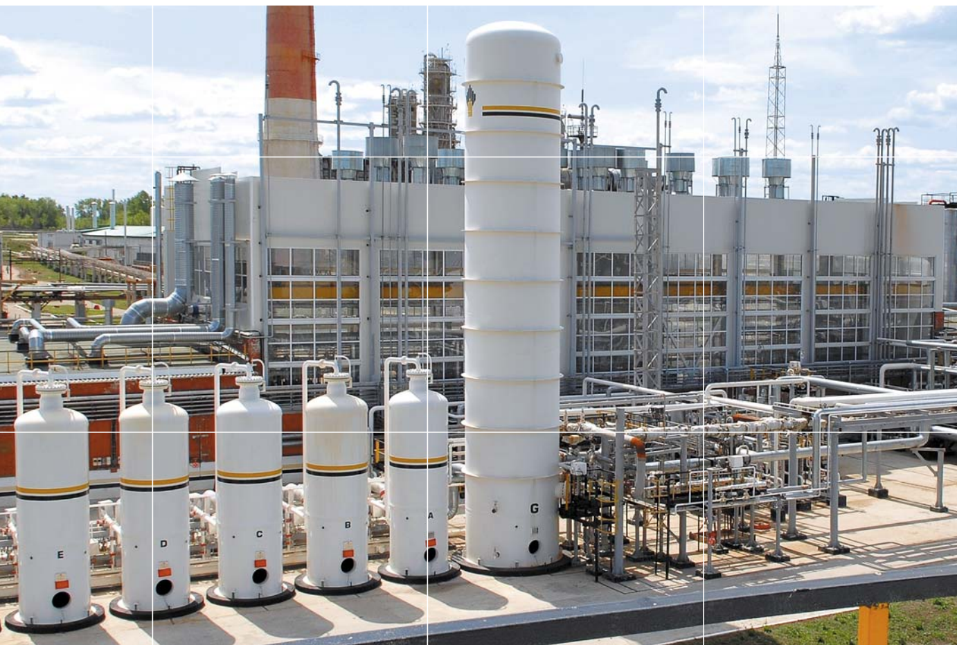
Установка короткоциклового адсорбции на Новокуйбышевском НПЗ
