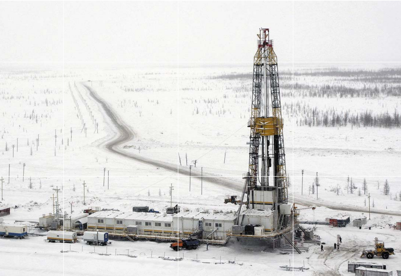
Кустовая площадка № 4 на Ванкорском месторождении
