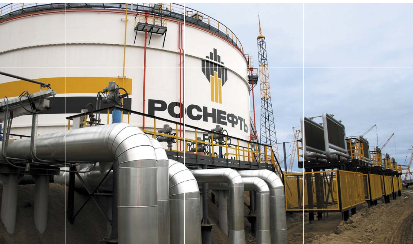
Установка предварительного сброса воды на Ванкорском месторождении
