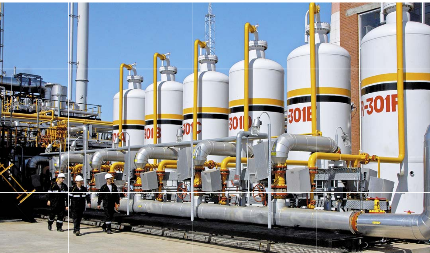
Установка производства водорода на Куйбышевском НПЗ
